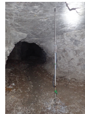
Canne de convergence visible dans la carrière « de Wett » sur la commune de Lille, faisant l'objet d'un suivi régulier depuis 20 ans © Service Commun des Carrières Souterraines - Ville de Lille
