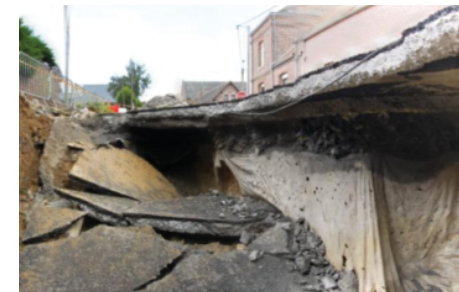
Effondrement d'une cavité à Rumilly, 1993 © Service Commun des Carrières Souterraines – Ville de Lille
