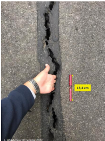
Fissure liée au retrait gonflement des argiles © CEREMA
