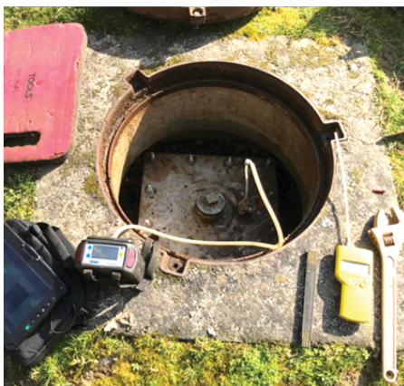
Dispositifs de surveillance de l'aléa émission de grisou, mesures périodiques manuelles, source : BRGM
